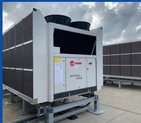
Equinix Datacenter - Reino Unido
